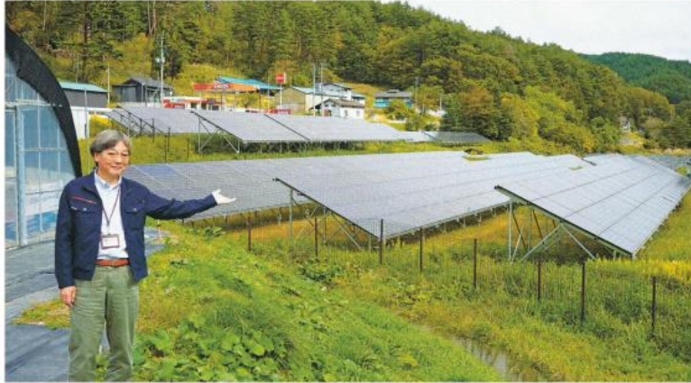
▲ 葛尾村に設置された太陽光パネル。左は葛尾創生電力の植村廣さん
