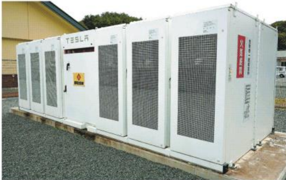
葛尾村に設置された大型の蓄電池
