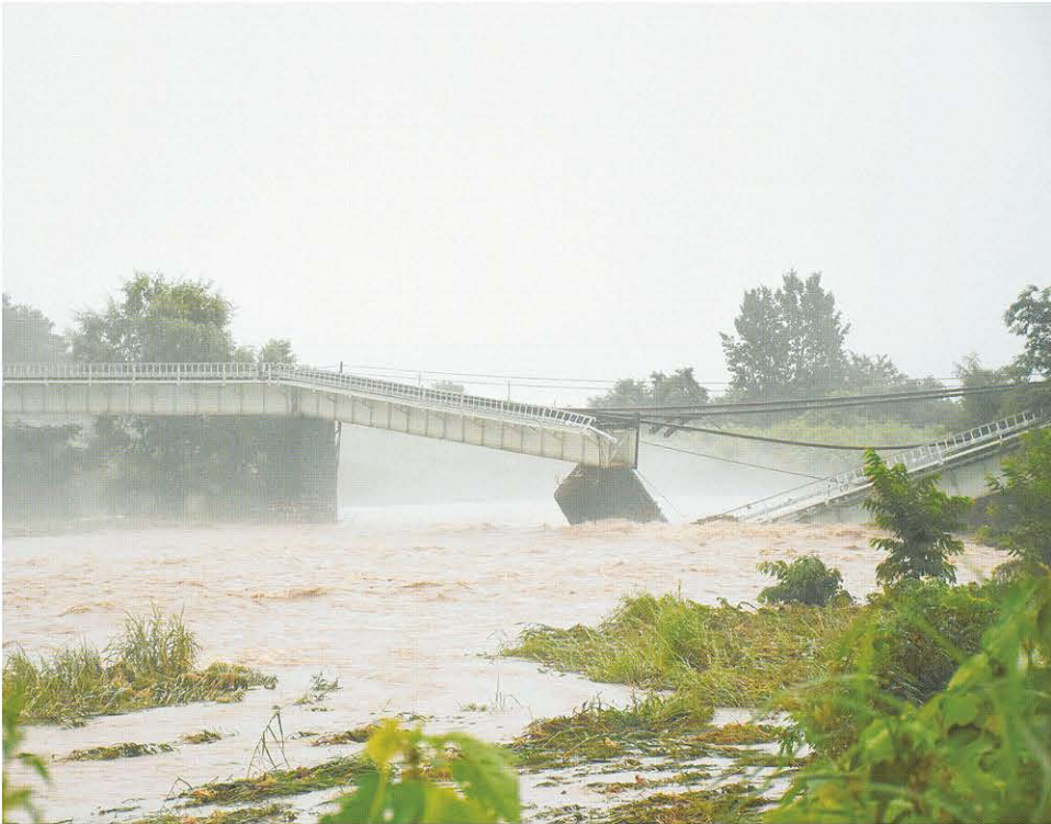
豪雨の影響で崩落したJR磐越西線の濁川橋梁—喜多方市
